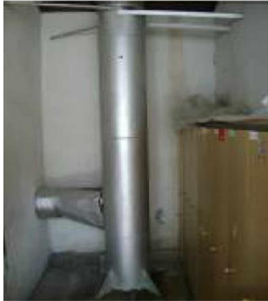
Слика од мерно место од вентилацискиот канал на котлара
